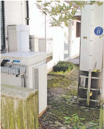
Die Schaltzentrale der Telekom. swb-Bild: hz
