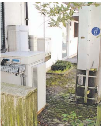
Die Schaltzentrale der Telekom. swb-Bild: hz
