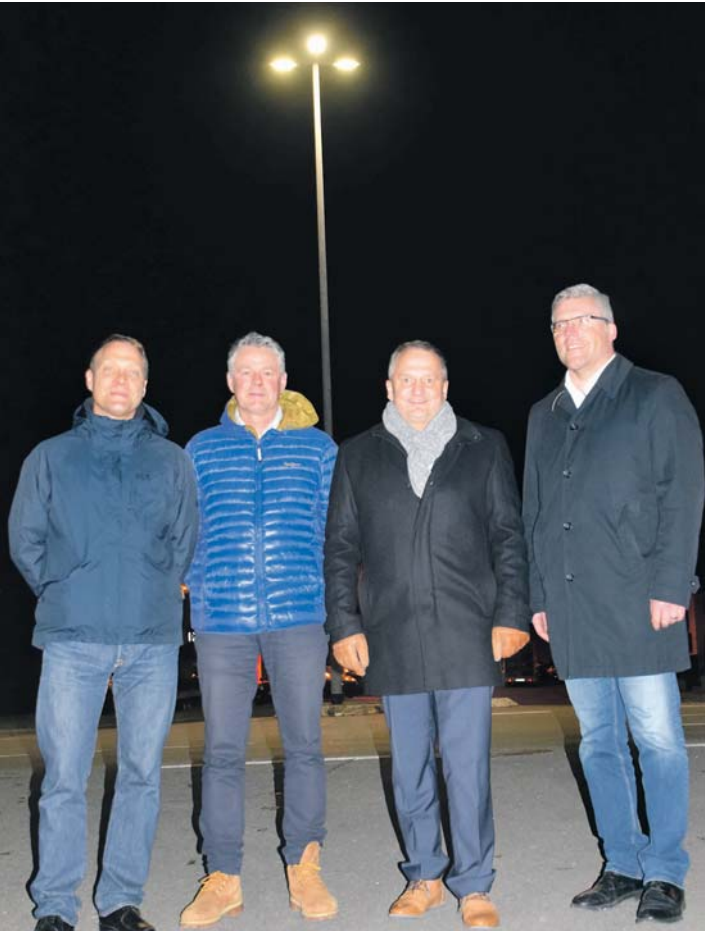
Machen sich stark für die Umrüstung der Straßenbeleuchtung auf LED, wie hier bei der Ortseinfahrt nach Böhringen: SWR-Geschäftsführer Andreas Reinhardt, Oberbürgermeister Martin Staab, Tiefbauleiter Uwe Negraß und Klimaschutzmanager Matthias Putzke.
