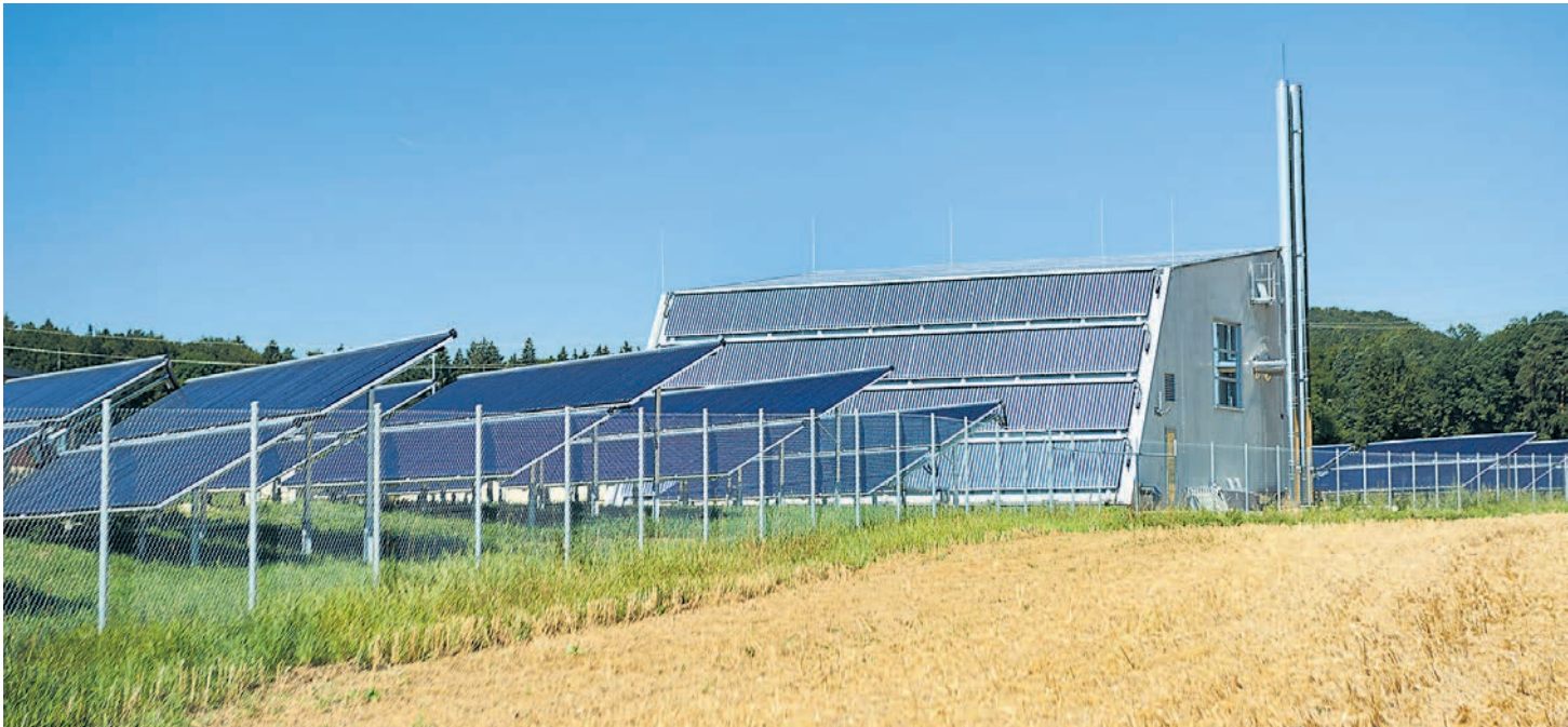
Ein Solarthermie-Kollektorfeld wie hier in Büsingen soll demnächst auch das Nahwärmenetz in Randegg ergänzen. swb-Bild: Solarcomplex
