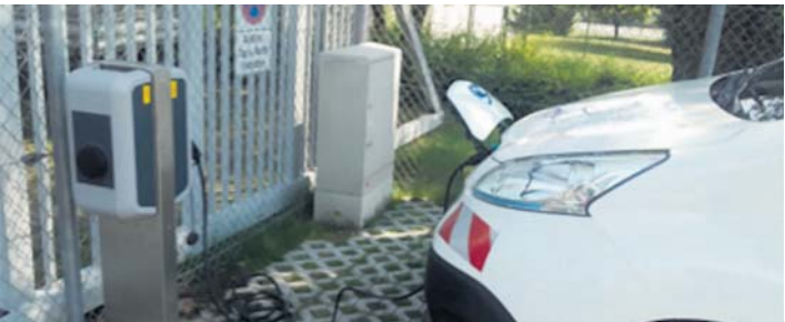
Die neue Ladestation am Bauhof. swb-Bild: Steißlingen
