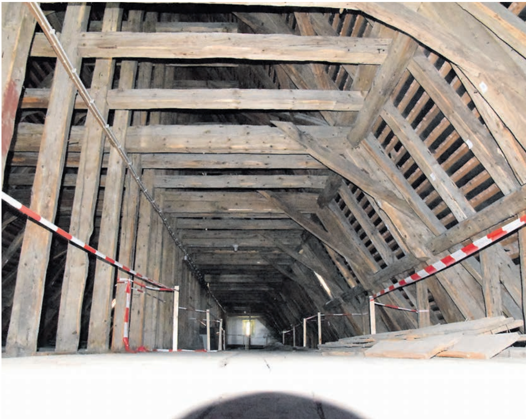
Dringend sanierungsbedürftig: Der Glockenturm des Radolfzeller Münsters.
