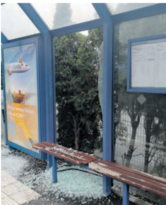
Eins von 18 beschädigten Buswartehäuschen in Singen. swb-Bild: Stadtwerke Singen
