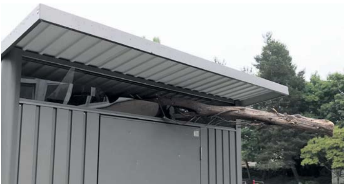
Das zerstörte Materialhäuschen.
