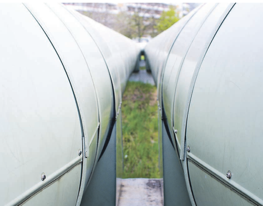
Dank Fernwärme wird der CO 2 Ausstoß deutlich reduziert. swb-Bild: BTH_Fernwaerme_shutterstock_272898995
