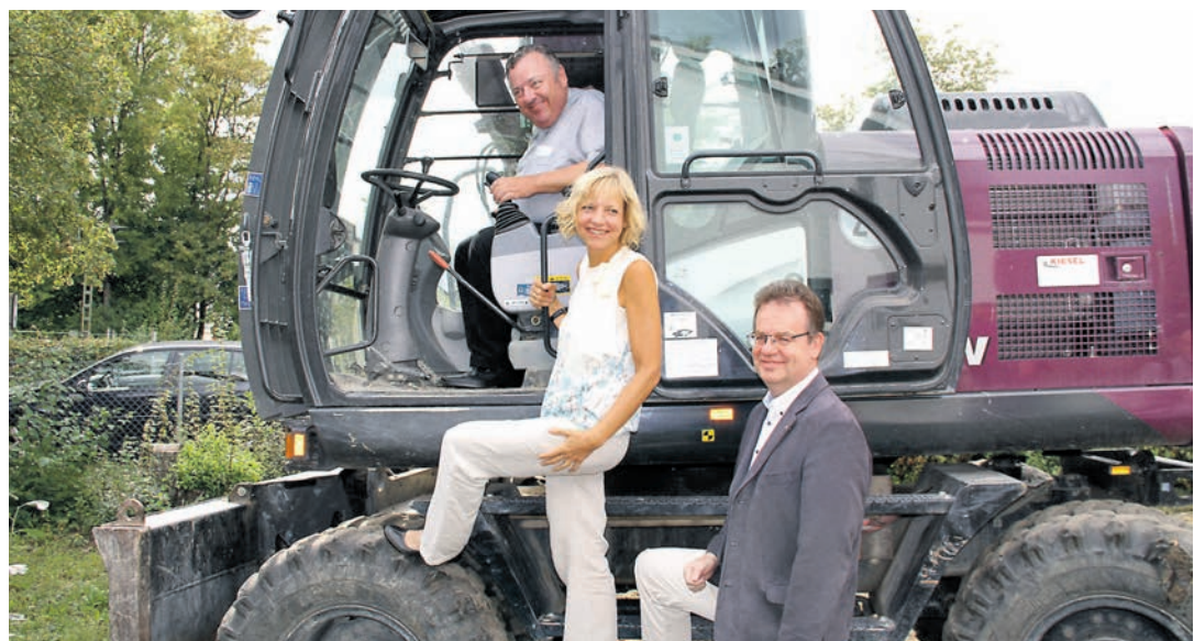
Einmal in einem Bagger sitzen. Beim Baggerbiss für den St. Hedwig Kindergarten-Neubau ging der Traum für Pfarrer Michael Hauser in Erfüllung. Mit von der Partie: Michaela Gesell, Geschäftsführerin der Kindergärten der Katholischen Kirchengemeinde, und Diakon Michael Dohm. sub-Bild: eck
