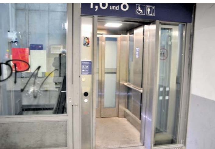
Die Aufzüge am Singener Bahnhof sind wieder betriebsbereit.
