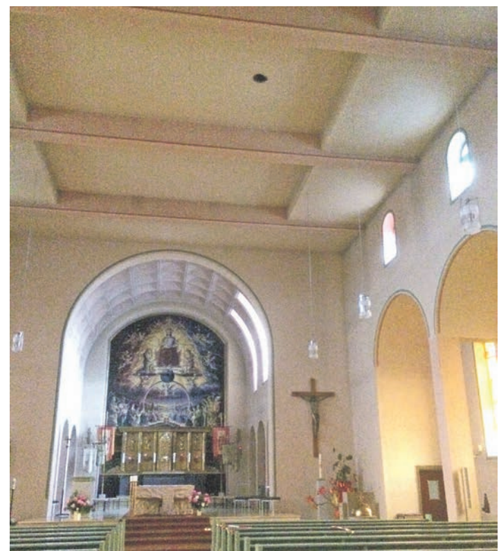
Ein rund 50 Zentimeter großes Teil der Decke in der Christkönigkirche hat sich in den letzten Tagen gelöst. Jetzt wurde die Kirche vorsorglich geschlossen. sub-Bild: Zimmermann/ Dekanat
