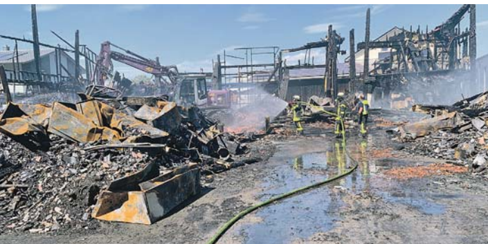
Feuerwehrleute bei den letzten Löscharbeiten in der ausgebrannten Halle.
