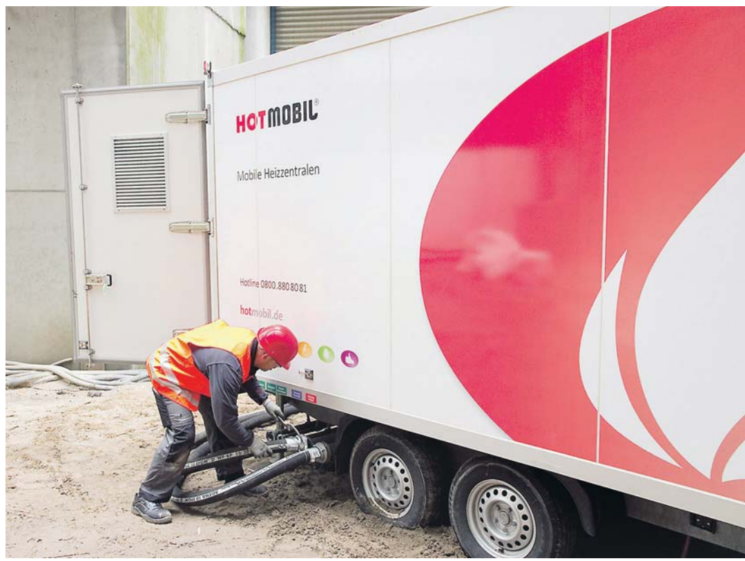
Im Bild der Anschluss mit Druckprüfung einer der mobilen Heizzentralen am Einsatzort. Das Unternehmen ist mit mehreren Standorten über die Zentrale in Gottmadingen hinaus im Bundesgebiet präsent.
