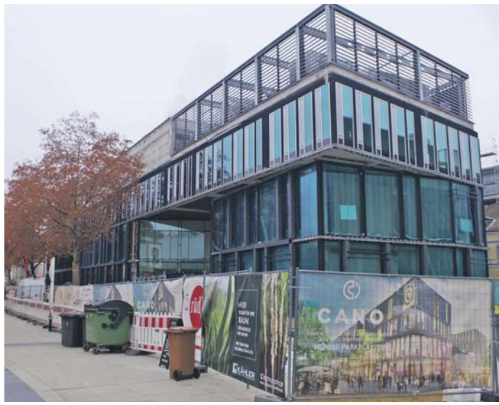
Das CANO-Gebäude sieht jeden Tag schon ein bisschen fertiger aus – nun wurde der neue Eröffnungstermin auf den 10. Dezember festgesetzt. sub-Bild: of
