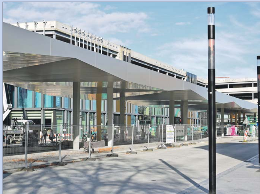
Sobald die Bauarbeiten an der Außenfassade des Cano abgeschlossen sind, kann der neue Bahnhofplatz geöffnet werden.
