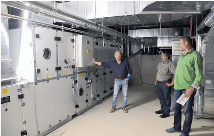
Bernhard Läufler gab einen Einblick in die komplexe Gebäudetechnik im Keller des Neubaus.
