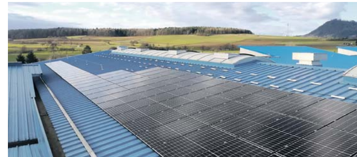
Die neue Photovoltaikanlage der Engener Firma allsafe erzeugt 750.000 kWh Strom jährlich. swb-Bild: allsafe GmbH & Co. KG
