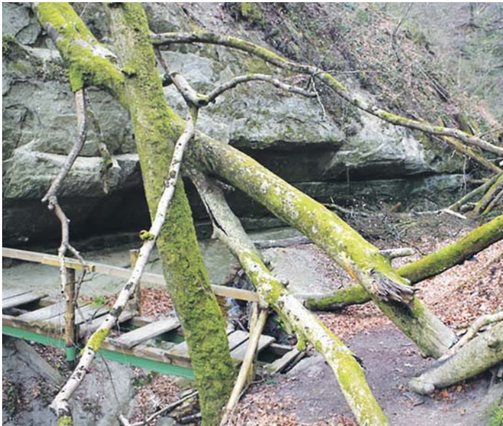
Die beschädigte Brücke in der Katharinenschlucht ist inzwischen repariert. swb-Bild: of
