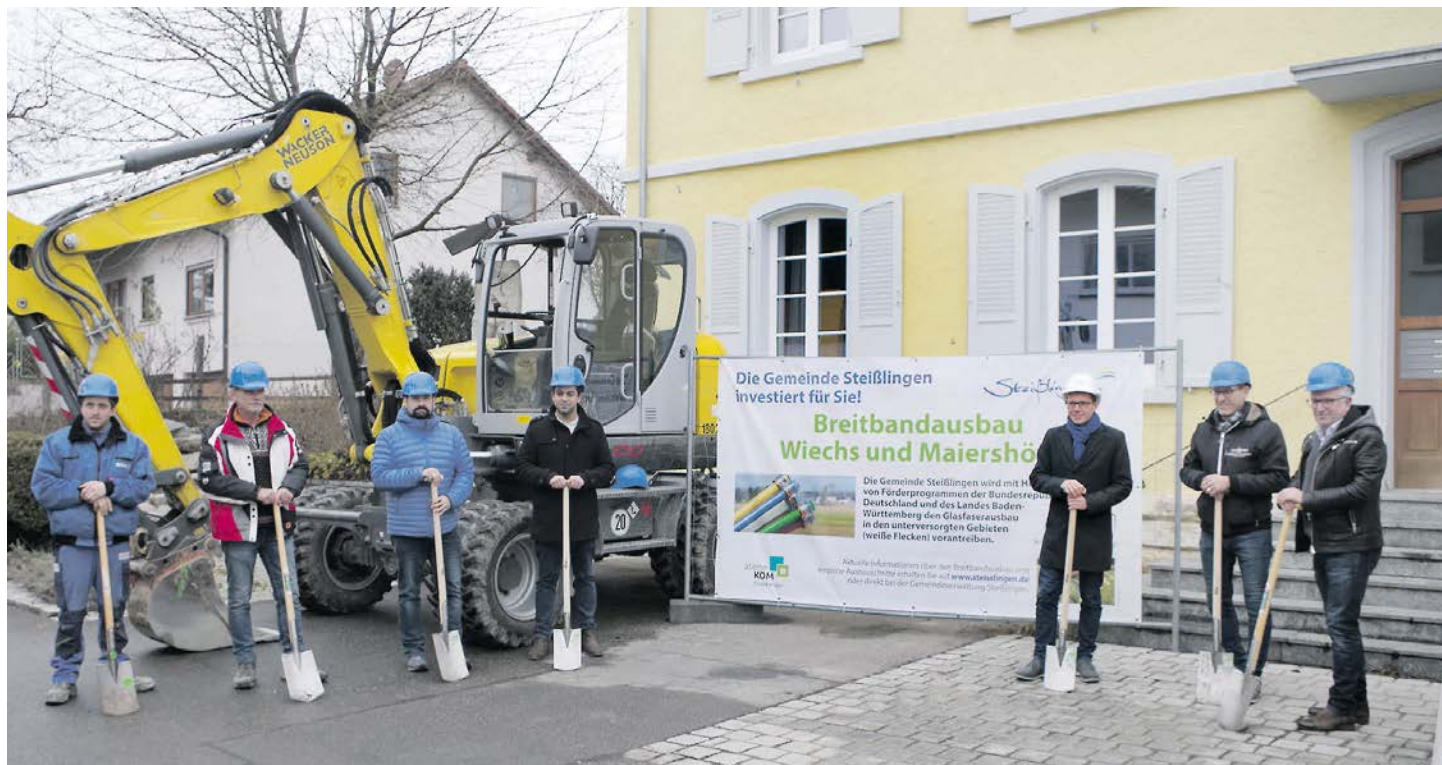
Beim sehr symbolischen Spatenstich vor dem Wiechser Gemeindehaus: Jan Maier vom Bauunternehmen Maier aus Baltersweil, Bauleiter Siegfried Löffler, Ortschaftsrat Volker Kuhn, Tamesch Wagner vom Fördergeber Atene Com, Bürgermeister Benjamin Mors, Bauamtsleiter Christian Weber und Burkard Raff als Planer der Tiefbaumaßnahme
