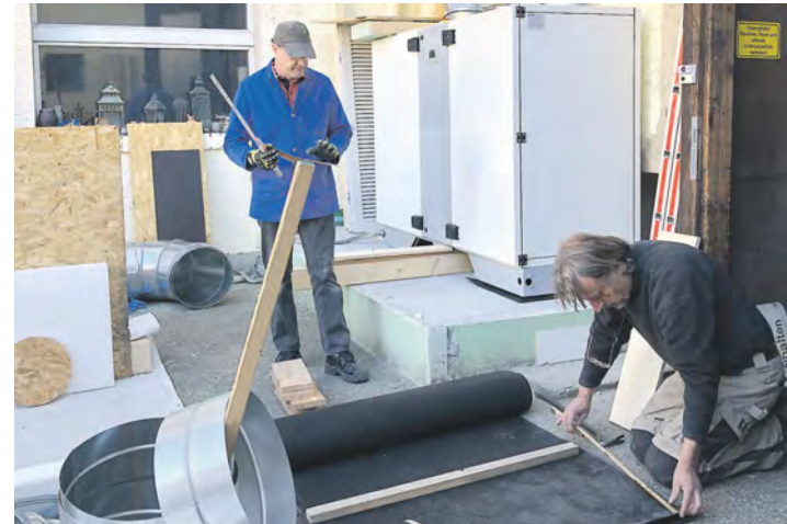
Andreas Nietschke (kniend) und Thomas Eberhard beim Aufbau der neuen Lüftungsanlage im Hof des Theaters. swb-Bild: Verein
