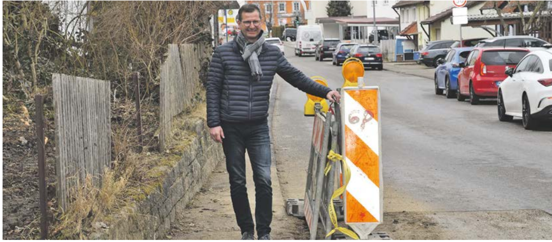
In der Ortsdurchfahrt in Mühlhausen stehen umfangreiche Sanierungsarbeiten an. Die Baustelle dafür wird am 15. März eingerichtet. Bürgermeister Patrick Stärk vor einer Warnbake, die wegen eines Wasserrohrbruchs vor einigen Tagen notwendig war, dessen Reparatur schon einmal einen Vorgeschmack auf die anstehenden Arbeiten gab.
