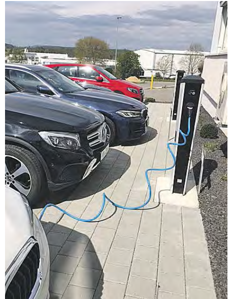
Die ersten zwei E-Ladesäulen sind bereits in Betrieb.
