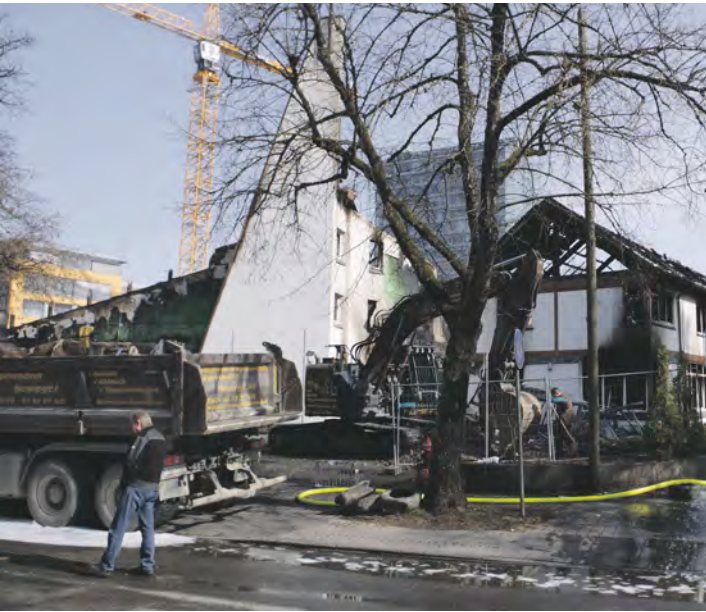
Die Friedenskirche in Singen am Morgen nach dem verheerenden Brand. Schon in der Nacht wurde ein Bagger geholt um Gebäudeteile zu entfernen.
