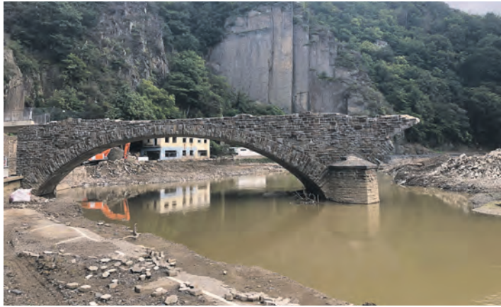
Die nahezu vollständig zerstörte historische Bogenbrücke über die Ahr. Die Wassermassen haben ganze Teile der gemauerten Brücke weggerissen. swb-Bild: Hilfsprojekt „Steißlingen hilft Altenahr“
