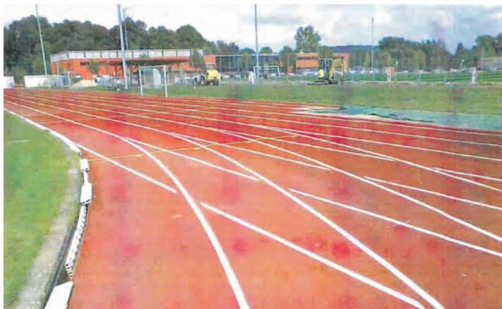
Die rinnen links im Bild zeigen, wie notwenig eine Sanierung der Sportbahn im der Leichtathletikanlage in der Talwiese ist. swb-Bild: SportBau/Gemeinde Rielasingen
