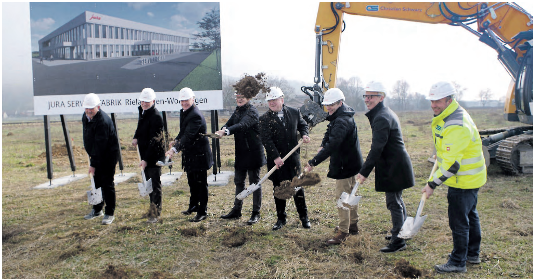
Beim Spatenstich am Zoll in Rielasingen: Peter von Rohr (Projektleiter Jura), Norbert Seeger (Leiter Jura Zentralservice Deutschland), Horst Nikolaus (Geschäftsführer Jura Deutschland), Emanuel Probst (CEO Jura), Bürgermeister Ralf Baumert, Architekt Manuel Cancio, Bauleiter Ben Nägele und Christian Schwarz (CS Erdbewegungen), der auch Nachbar der neuen Servicezentrale ist.
