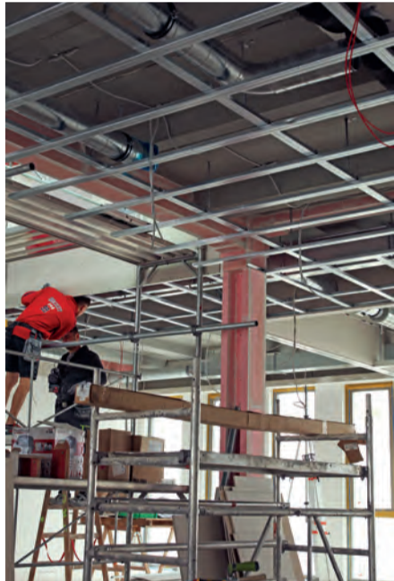
Gebäude sind mehr als das Sichtbare. Verborgen ist eine umfangreiche Technik.
