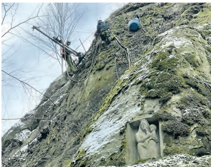
Im Dezember wurden mit Hubschrauberunterstützung die Anker für Steg durch die Marienschlucht eingepresst. swb-Bild: Weckbach
