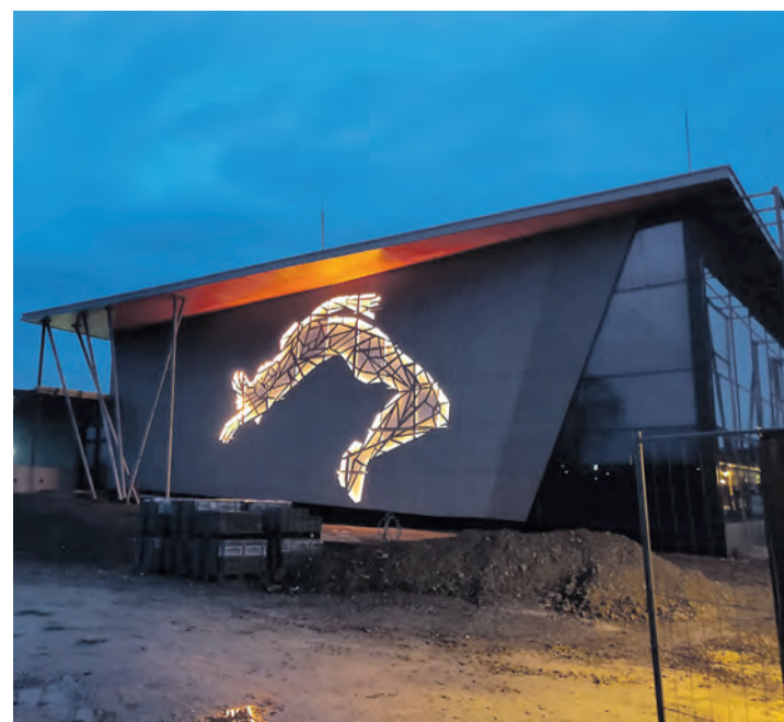
Der Wasserschaden verzögert die Einweihung der Halle weiter, die Außenanlagen befinden sich noch im Bau. swb-Bild: Anja Kurz
