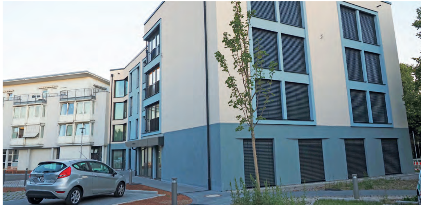
Das Gebäude für die Erweiterung des Pflegezentrums St. Verena ist inzwischen fertiggestellt und soll in den nächsten Wochen bezogen werden können. Damit wird Platz gemacht für die weiteren Umbauarbeiten, die noch im Pflegezentrum nötig sind. swb-Bild: Oliver Fiedler
