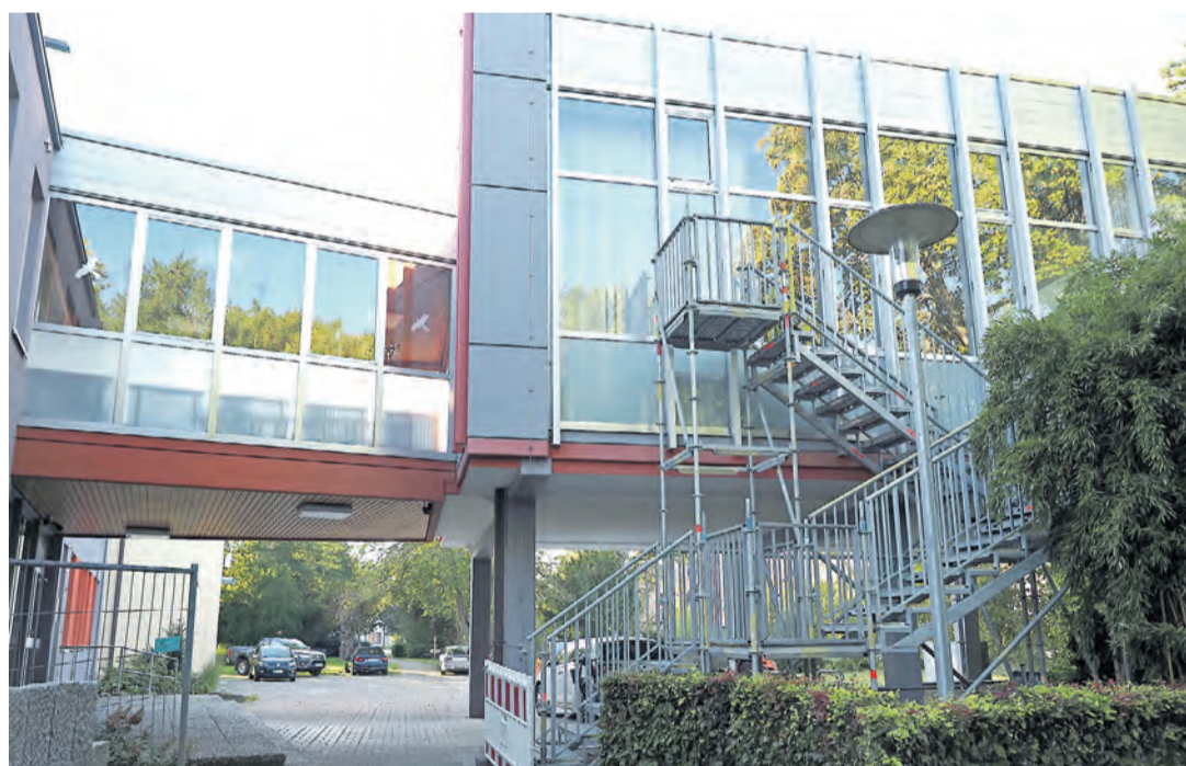
Die am Ratssaal angebaute provisorische Treppe ist nur ein Dokument mangelhaften Brandschutzes im Rathaus von Rielasingen-Worblingen. Deshalb soll nun ein möglicher Neubau vorbereitet werden. sub-Bild: Oliver Fiedler
