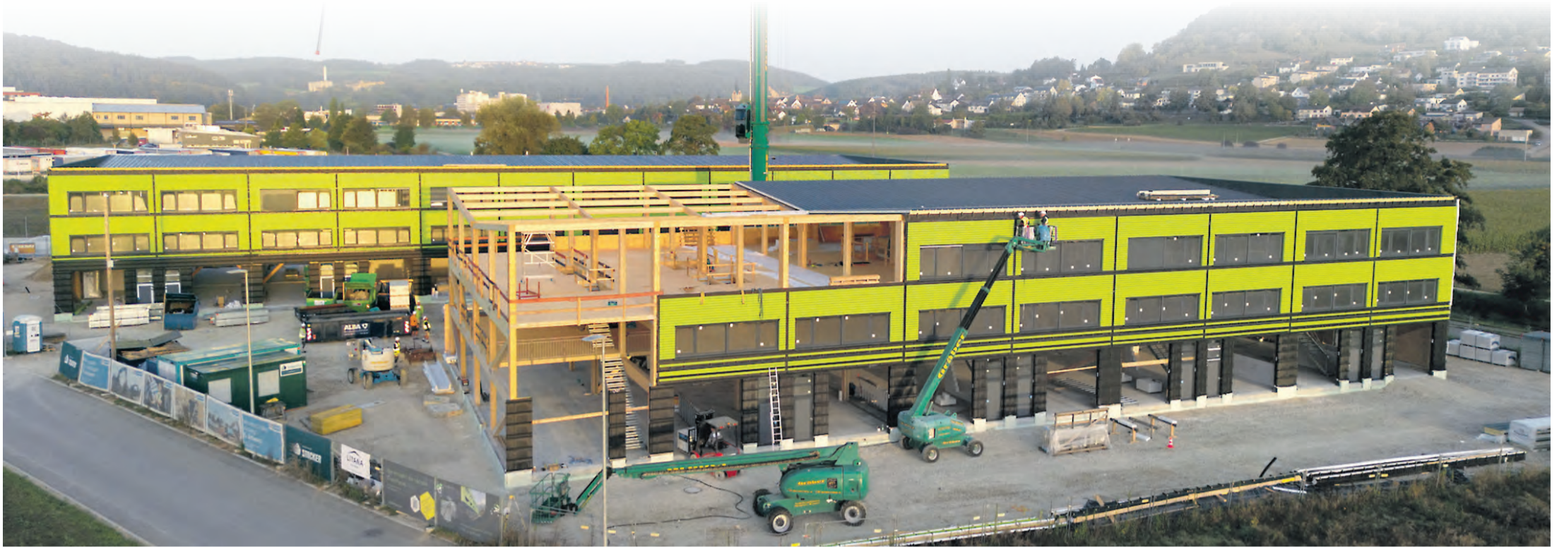
Die Bauarbeiten an den Green Places in Bietingen sind fast abgeschlossen. Schon im Januar sollen die ersten Mieter und Käufer einziehen.
