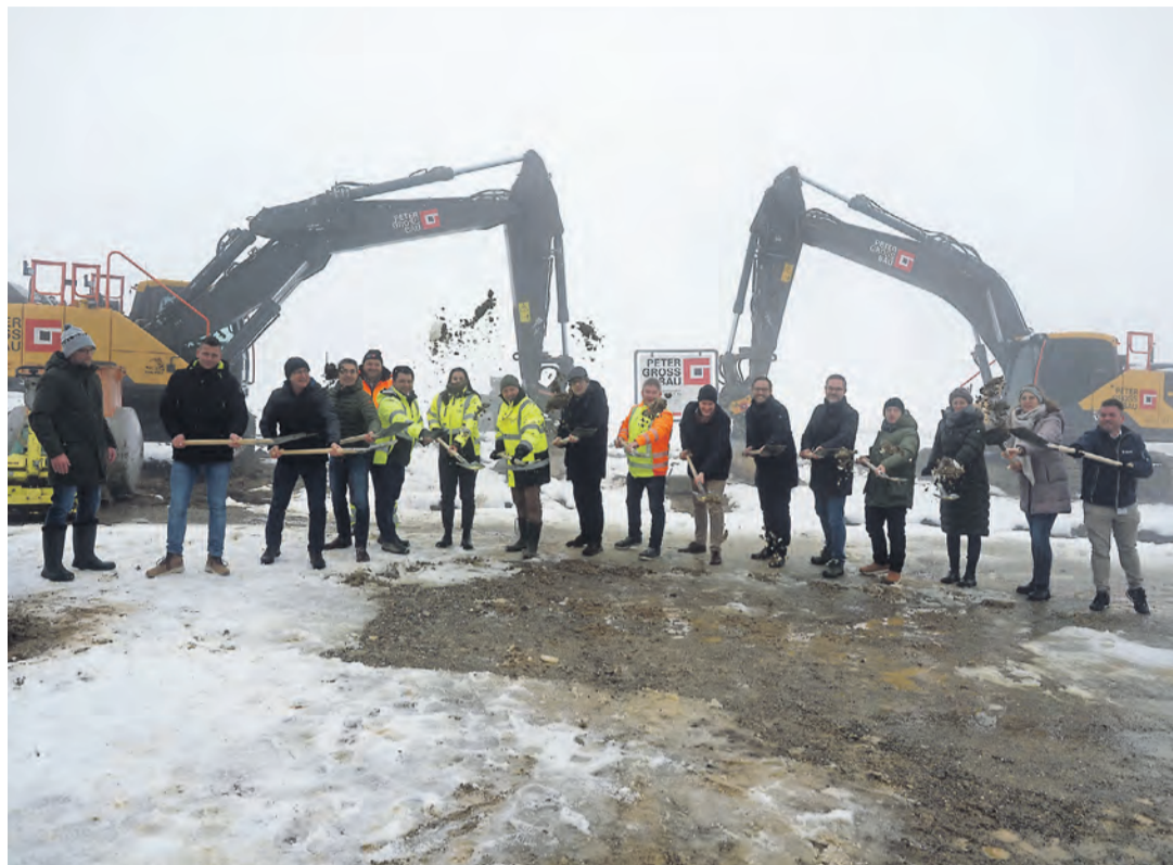
Viele Partner haben das neue Baugebiet „Röschberg Süd“ in Hohenfels-Liggersdorf in vier Jahren zur Erschließungsreife gebracht. Nun konnte der symbolische Spatenstich vollzogen werden. sub-Bild: Oliver Fiedler
