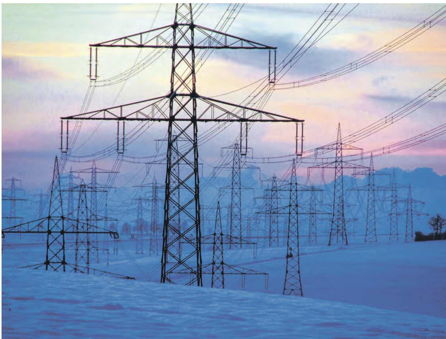
Der Landkreis Konstanz ist derzeit eine Region, die sehr viel Strom „importieren“ muss, wenn es auch solcher aus Wasserkraft ist, wie hier an der Hochspannungstrasse bei Tengen, die die Landschaft markant prägt. Das wird auch durch noch mehr eigene regenerative Energieproduktion im Landkreis so bleiben, sagen neue Studien. swb-Bild: Oliver Fiedler
