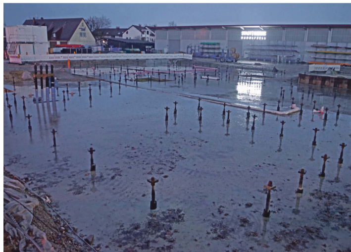
Die Baustelle für den Neubau der Stadtwerke Radolfzell wird bis zum Spätsommer erst einmal ruhen. Grund sind die starken Preisanstiege im letzten Herbst. swb-Bild: Oliver Fiedler
