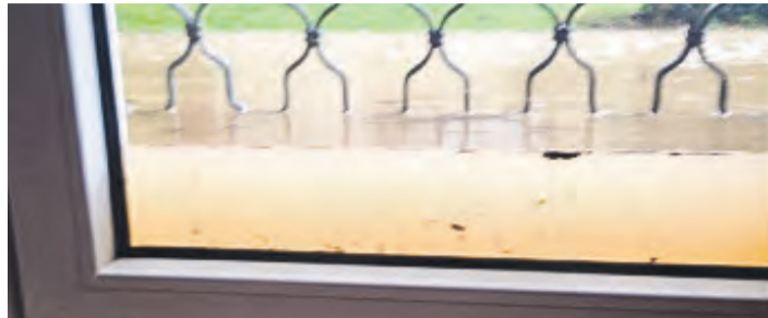
Ein Beispiel aus Arlen, wo nur das dichte Fenster einen größeren Schaden verhinderte. sub-Bild: Gemeinde Rielasingen-Worblingen/Privat
