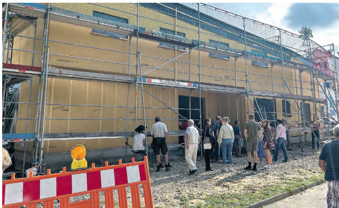
Mit dem Richtfest konnte beim Gemeindehaus der Evangelischen Gemeinde Singen ein weiteres Etappenziel gefeiert werden. sub-Bild: Tobias Lanac
