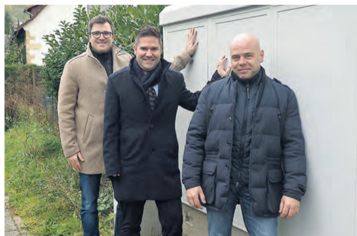
Felix Gieger von Stiegeler Internet Service, Bürgermeister Holger Mayer und Ortsvorsteher Stefan Rill an einem der neuen Verteilerkästen, an denen das Glasfasersignal nun in Binningen ankommt. swb-Bild: Oliver Fiedler
