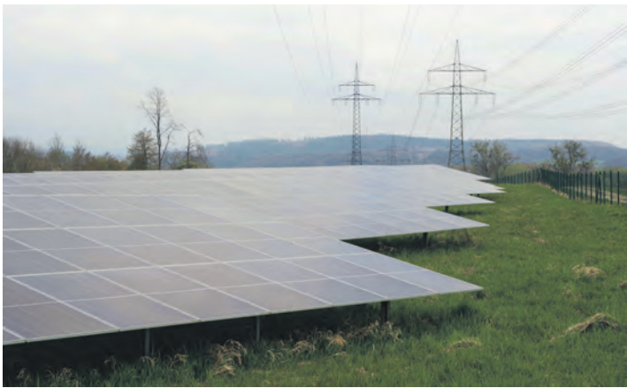
Singen bräuchte zur Stärkung der lokalen Stromerzeugung noch viele Flächen für Photovoltaik, wenn schon Windkraft kein Thema ist. Im Bild die im letzten Herbst in Betrieb gegangene Anlage des Bürgervereins Beuren, die die Stadt Singen beliefert. swb-Bild: Oliver Fiedler
