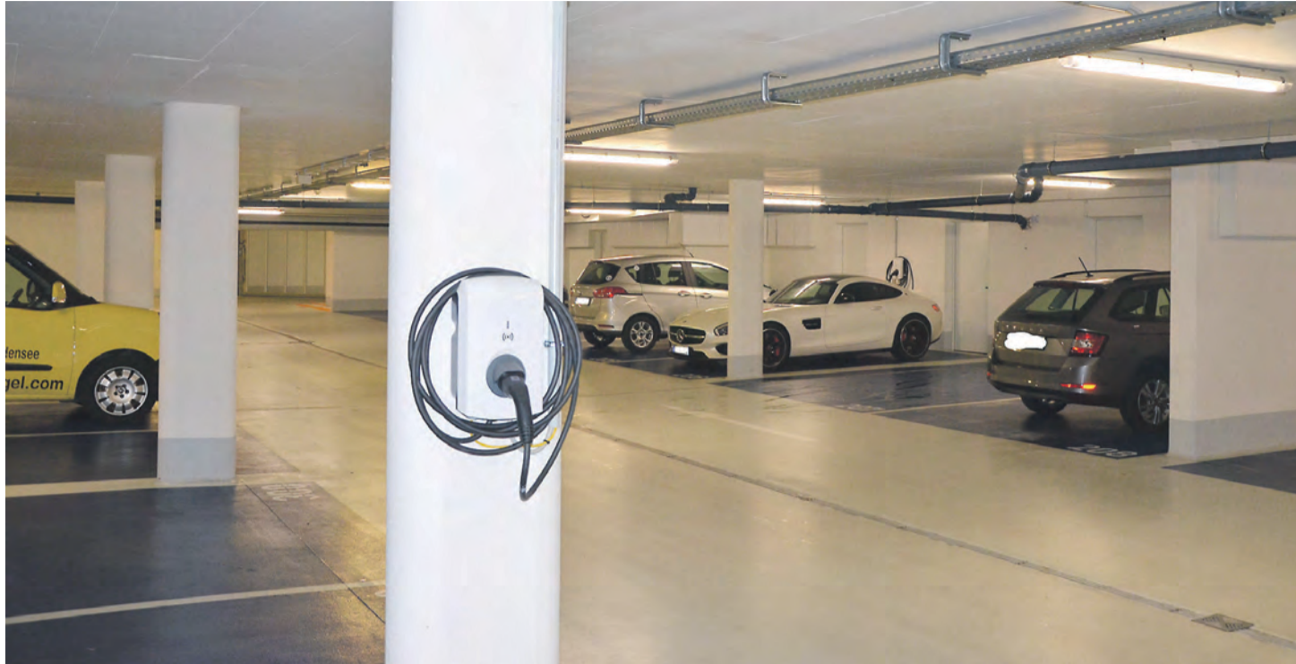
In dieser Tiefgarage wurde eine Lade-Infrastruktur installiert.
