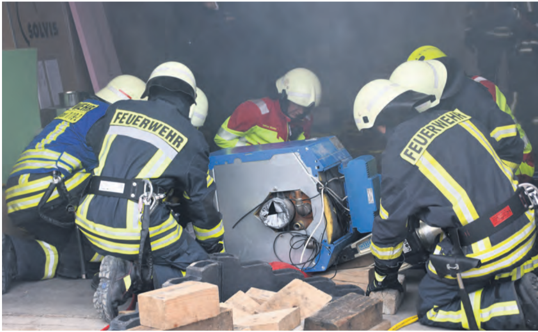
Mit Spreizer und Schere hoben die Einsatzkräfte der Feuerwehr Eigeltingen den Heizkessel an, der bei der Jahreshauptübung bei der Firma Bothe-Reichle Rauchauslöser war. sub-Bild: Philipp Findling
