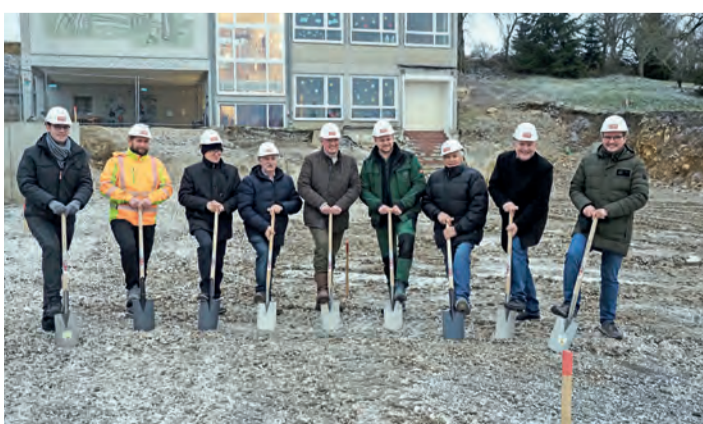
Die Beteiligten des Neubaus der Tudoburghalle konnten aufgrund des gefrorenen Bodens keinen „echten“ Spatenstich vollziehen. swb-Bild: Oliver Fiedler
