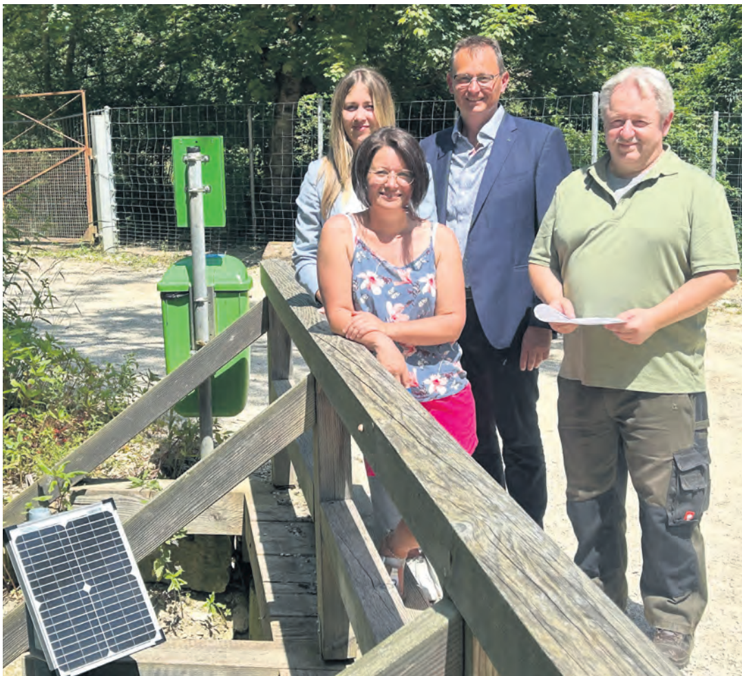
Sarah Falkenstein (hinten, von links) und Stephan Einsiedler von der Netze BW sowie stellvertretende Hauptamtsleiterin Christina Klaus (vorne, von links) und Revierleiter Reiner Strähle an einem von elf Pegelmesssensoren (links, unten) in Eigeltingen.
