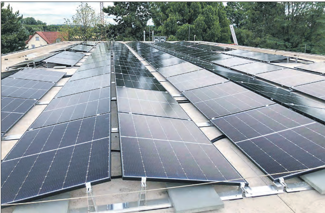
Photovoltaik-Anlage auf dem Dach der Hohenkrähenhalle im Singener Ortsteil Schlatt unter Krähen.
