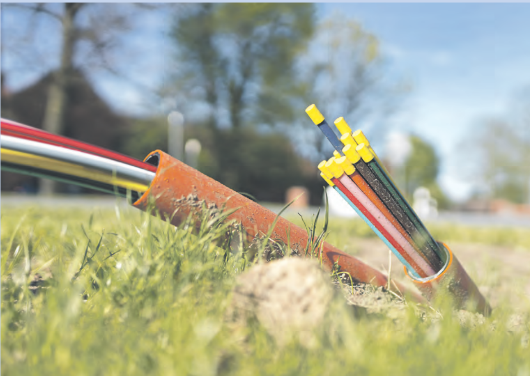
Ein zukunftsfähiges Glasfasernetz stellt eine dauerhaft leistungsfähige Infrastruktur dar, außerdem wird beim Datentransfer deutlich weniger Energie verbraucht.
