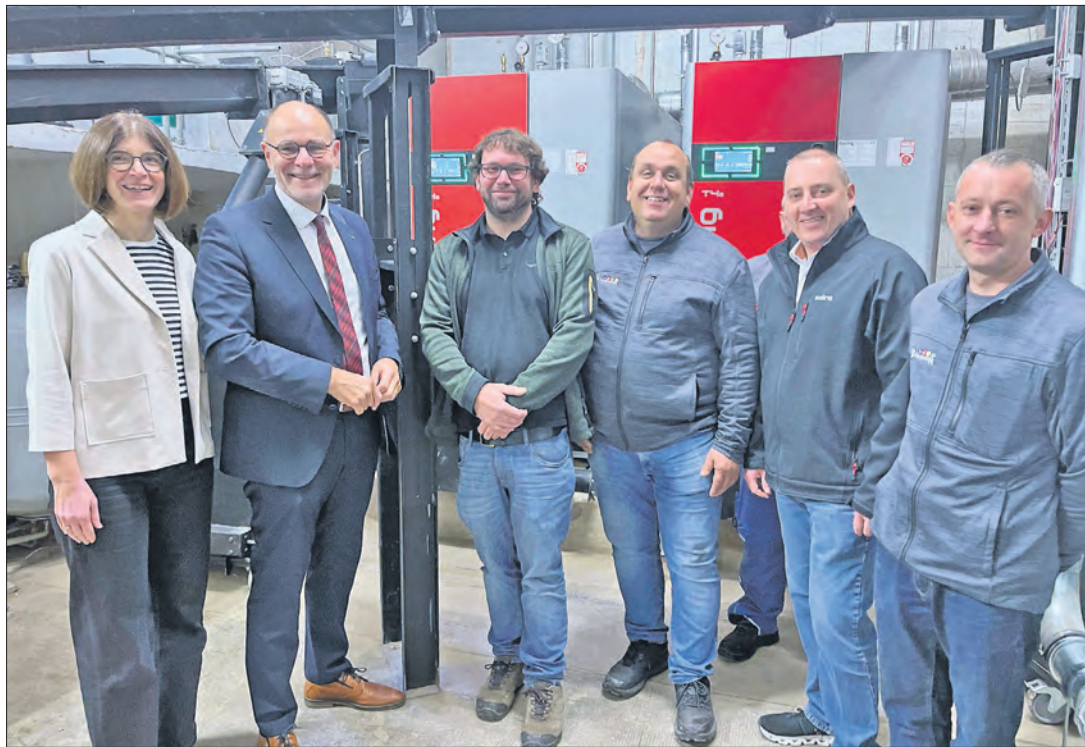
Vor den zwei Heizkesseln der neuen Hackschnitzelanlage im Keller der Waldeck-Schule (von links): Schulleiterin Anja Claßen, Oberbürgermeister Bernd Häusler, Bauleiter Thomas Ruther (Gebäudemanagement Stadt Singen), Geschäftsführer Michael Bürsner, Thorsten Bauer (Gebietsleiter Fröling) und Denis Spnev (Firma Bürsner).
