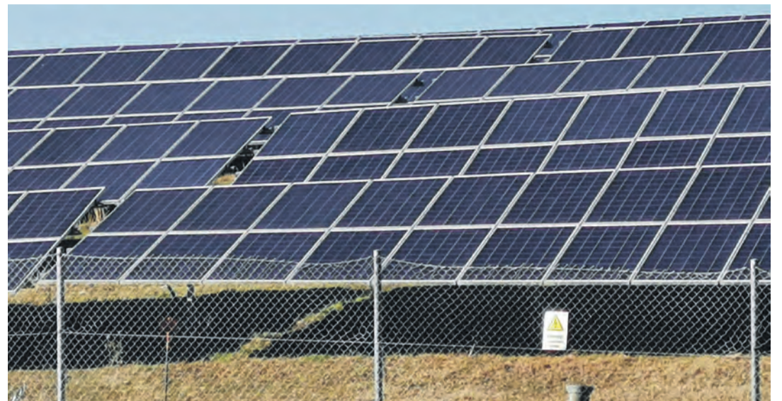
Ein Solarpark ähnlich dem bei Rickelshausen soll demnächst in den ehemaligen Worblinger Kiesgruben aus dem Gewinn „Krumme Reute“ entstehen.
