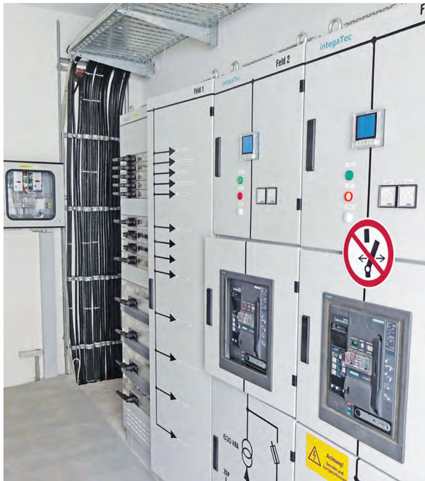
Komplexität im Gewerbebetrieb: Schaltschrank von Schrödl montiert
