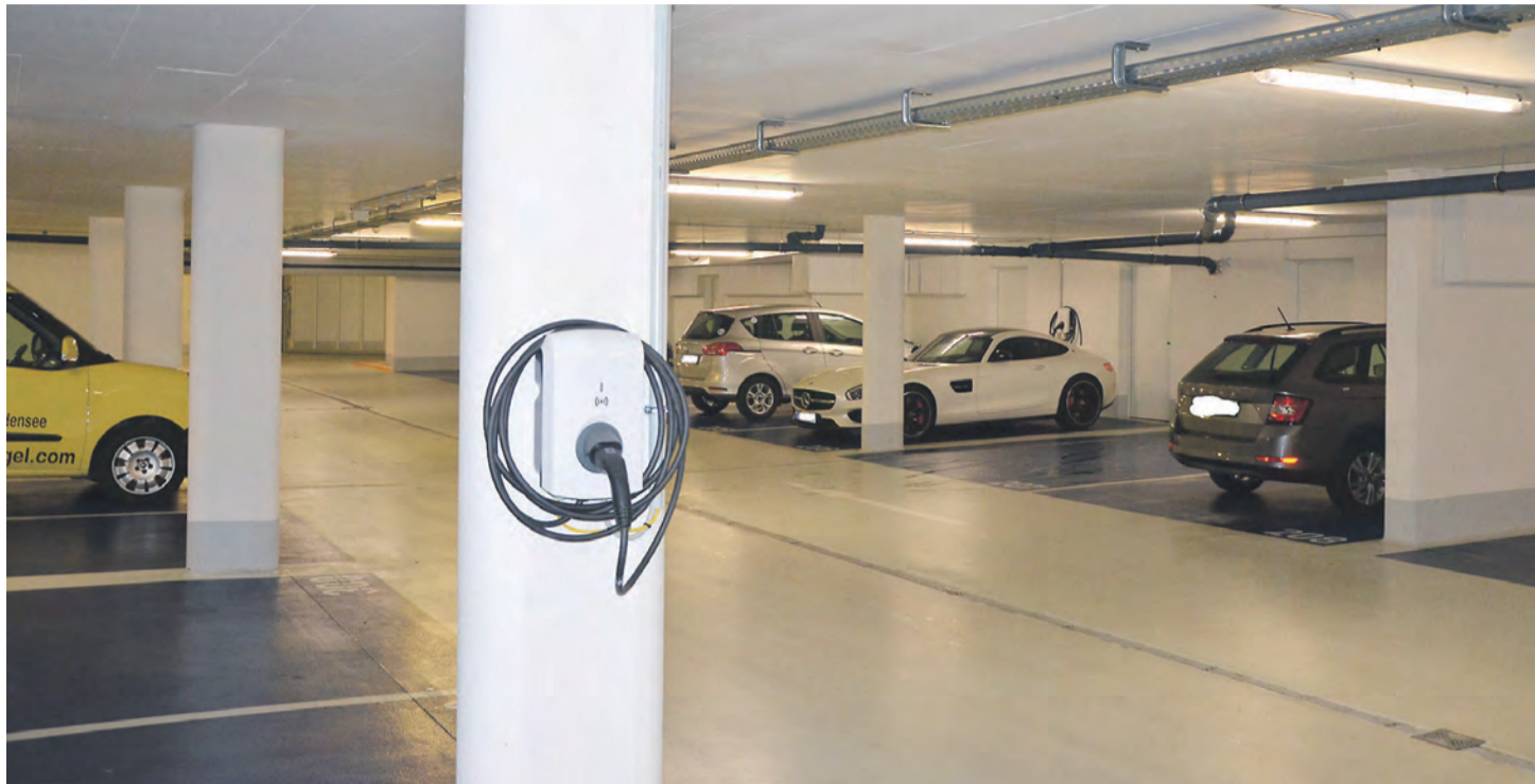
In dieser Tiefgarage wurde eine Lade-Infrastruktur installiert.
