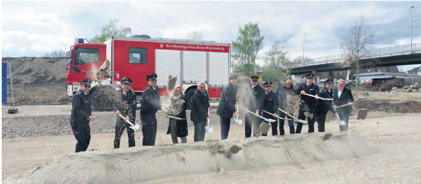
Das wurde richtig mit Schwung der Spaten für die neue Atemschutz-Übungsanlage (ASÜ) des Landkreises im Rielasinger Gewerbegebiet durch die Vertreter des Landkreises und der Feuerwehren geschwungen. Vor zehn Jahren begann die Diskussion darüber.
