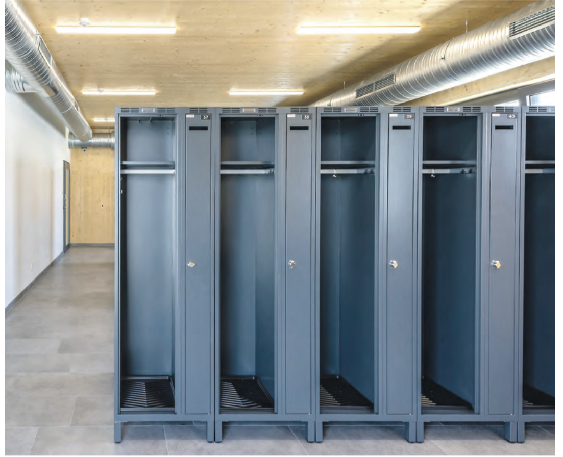
In den Umkleiden im THW-Gebäude reihen sich die Spinde aneinander. Hier bewahren die Helferinnen und Helfer ihre Ausrüstung auf, für Übungen oder Einsätze. swb-Bild: Staatliches Hochbauamt Freiburg
